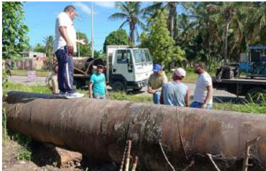
Equipos de Hidrocaribe atienden los daños que se le causan a las tuberías. CORTESÍA
