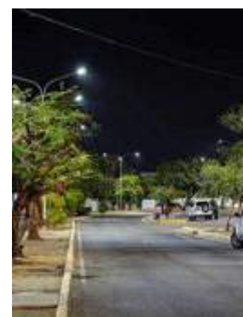
Vista de la Prolongación C2 con nuevas luminarias. VERSIÓN FINAL
