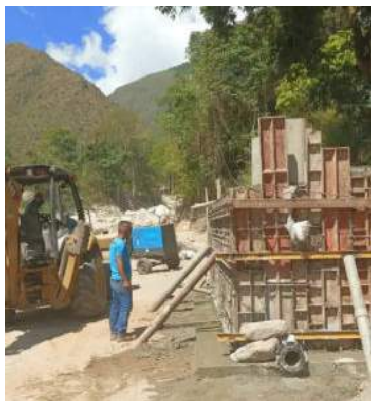
Se incluye la conexión desde un desarenador a una batería de tanques. CORTESÍA
