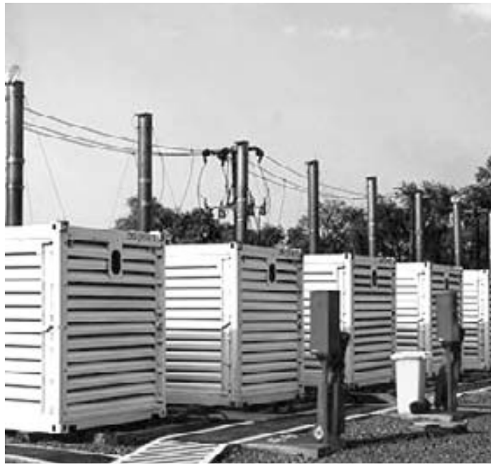
Se instalarán 20 motogeneradores de energía en campo de crudo ARCHIVO
